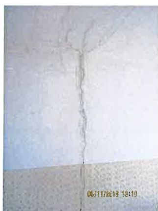
11.FISURI IN PERETE
