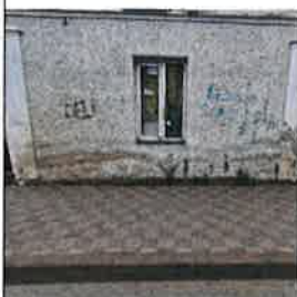
Infiltratii de apa la soclu si perete
