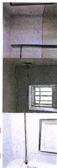
Fisuri in zidarie si tavan
