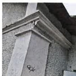
Degradari ale cornisei
