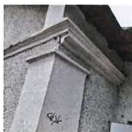
Degradari ale cornisei
