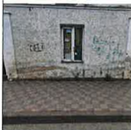
Infiltratii de apa la soclu si perete
