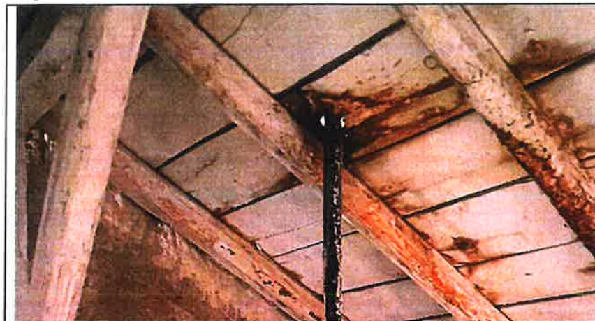
Fig. 2.a. Elemente degradate, umede, putrezite din zona adiacentă străpungerii acoperișului cu instalația de paratrăznet.
