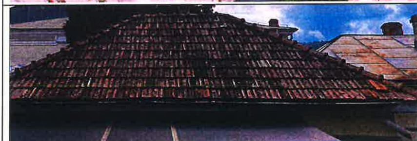
Fig. 2.h. Invelitoare degradată, cu țigle fisurate și friabile.
