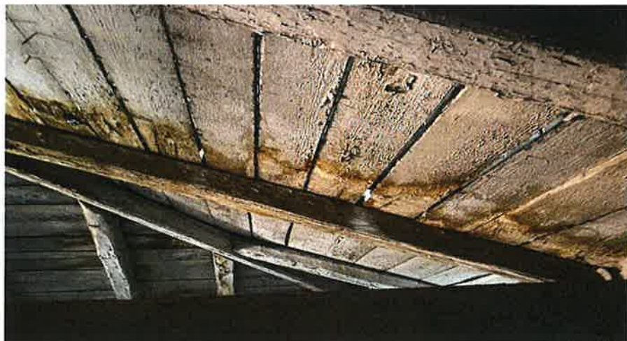
Degradariile sarpantei din lemn cauzate de infiltratiile de apa – corp C1
