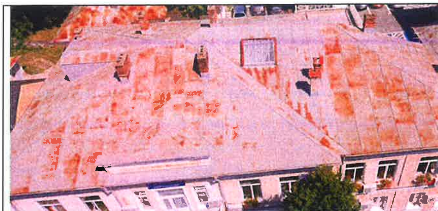
Fig. 2.g. Invelitoare din tablă plană degradată.
