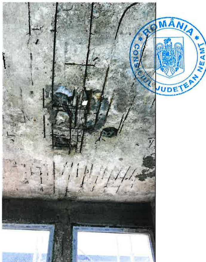
Foto 5.10- Armături expuse și afectate major de coroziune
