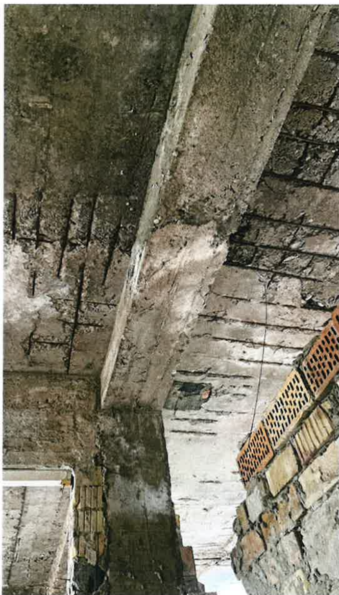
Foto 5.6- Rosturi de turnare în grinzi greșit realizate și armături vizibile la nivelul plăcilor
