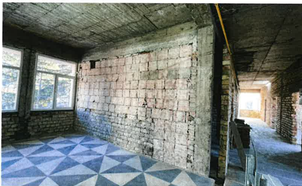
Foto 5.5- Pereți din zidărie care sunt realizați din mai multe tipuri de blocuri ceramice și pereți care nu sunt înrâmați în cadre, sunt la o distanță de aproximativ 20cm de cadrele din beton armat și nu prezintă ancorări
