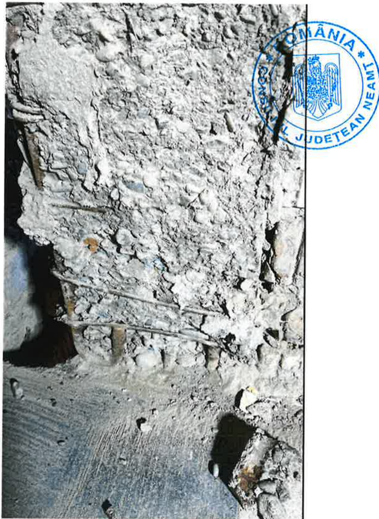
Foto 5.7- Carcase de armatură de la stâlpii de la nivelul 2 care nu au corespondent cu armatura de la nivelul 1 și segregări majore
